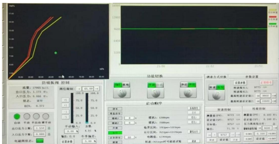
图 7 实施后防喘振调速控制面板总貌
